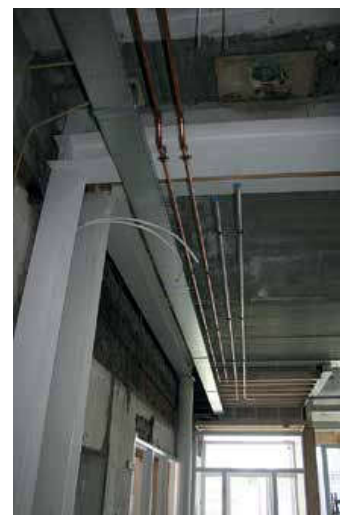
Voor de E-installaties loopt er een kabelgoot door het gebouw.
