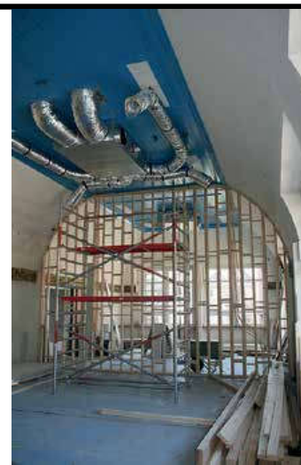
Door de hoge plafonds, zoals in de voormalige gymzaal, zijn oplossingen gevonden om de warmte omlaag te krijgen.
